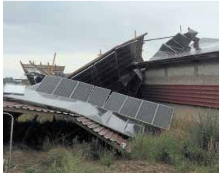
Zur regelmäßigen Wartung gehört auch ein Überprüfen der Montagegestelle, sonst kann die Fotovoltaikanlage nach einem Sturm so aussehen.
